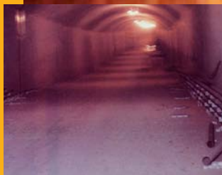
Ligne Métro N°2, Tronçon La-Savane / Du-Collège
